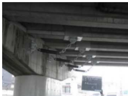
【対策事例：落橋防止装置】
