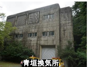
【耐震性能不足】
