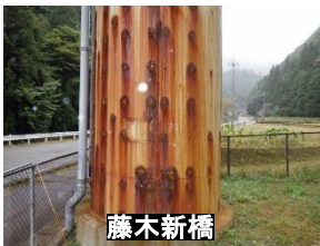
【橋脚巻立て鋼板の腐食】
